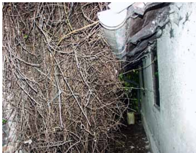
Zanedbaný stav Mendelova včelína v roce 2001
